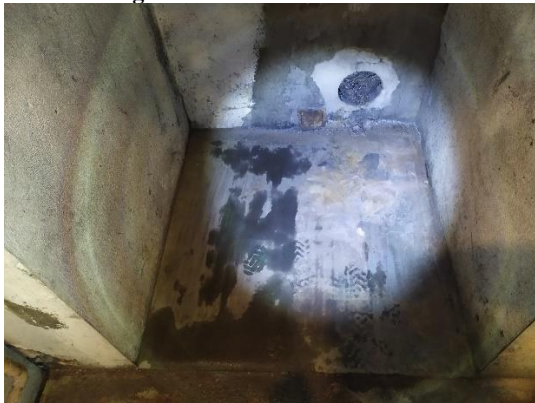
Figur 5. Utrymmet rakt framöver från ingången. Där något okänt ser ut ha varit installerat i väggen. De mörka fläckarna på golvet är vatten/fukt blandat med smuts. Inuti hålet i väggen fanns något som såg ut som trä/kolrester.
